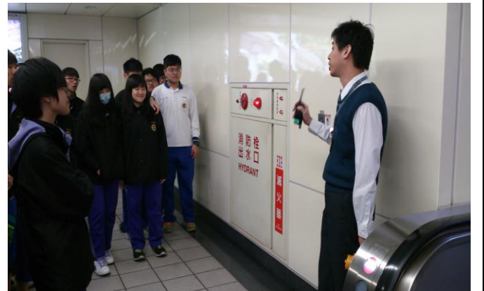
滅火設施說明
